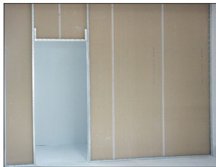
2. ติดแผ่นโซลิดวอลล์ด้านแรกเข้ากับโครงคร่าว ผนังโซลิดด้วย 50 มม. ยึดด้วยสกรู 38
